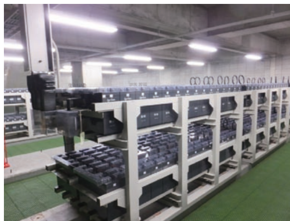
バッテリー室
