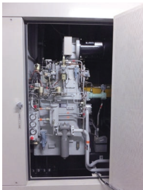
ガスタービン発電機
