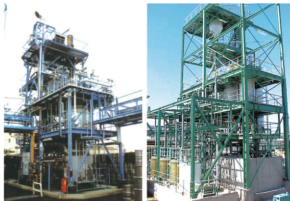
図8 液中燃焼法によるフロン等処理設備 (左) 液中燃焼炉（ダイキン工業株式会社 淀川製作所） (右) 後処理設備（旭硝子株式会社 鹿島工場）
